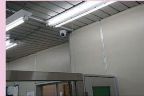
定期券発売所に設置した防犯カメラ
